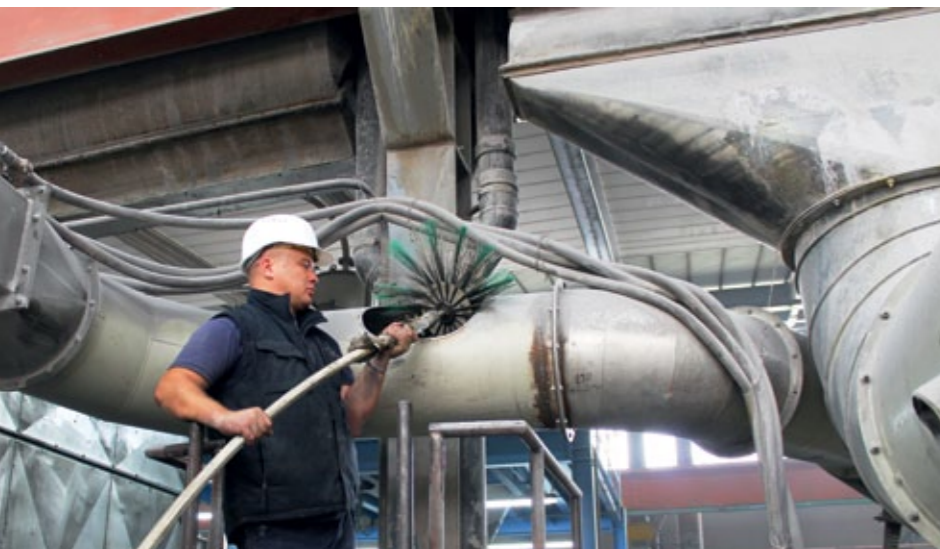
Eine rotierende Spezialbürste wird in die Rohrleitung eingeführt und löst die Beläge von den Rohrwänden. Die Absauganlage bleibt während dieses Vorgangs in Betrieb
