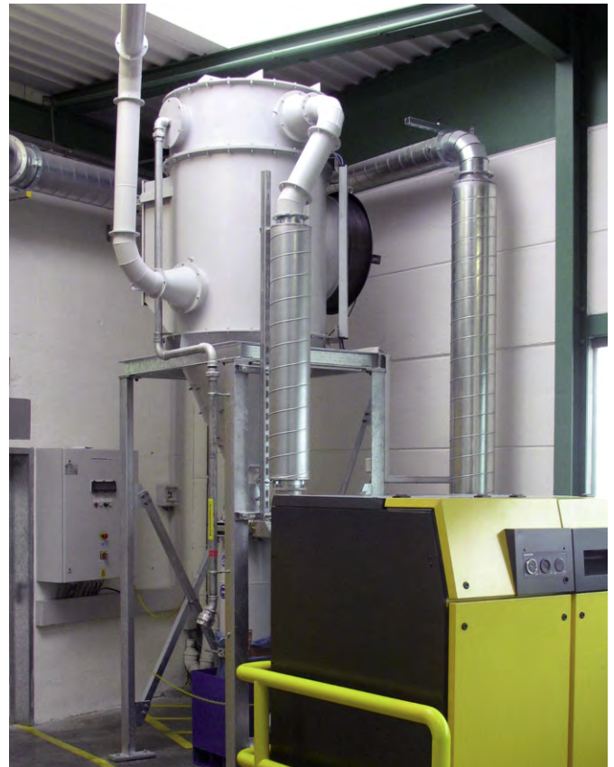
Vakuum-Sauganlage für explosible Stäube
