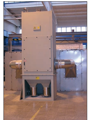
Schleifkabinenabsaugung durch einen VARIO 3 eco
