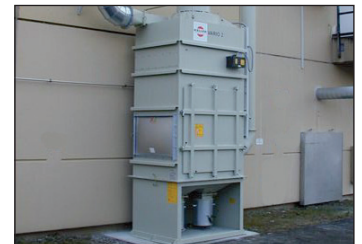
Berstscheibe zur Explosionsdruckentlastung im Freien
