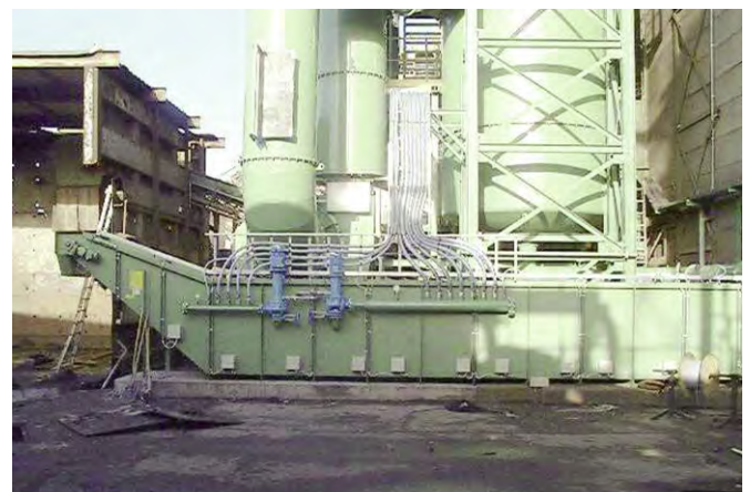
Wasseraufbereitung für Shredderentstaubung
