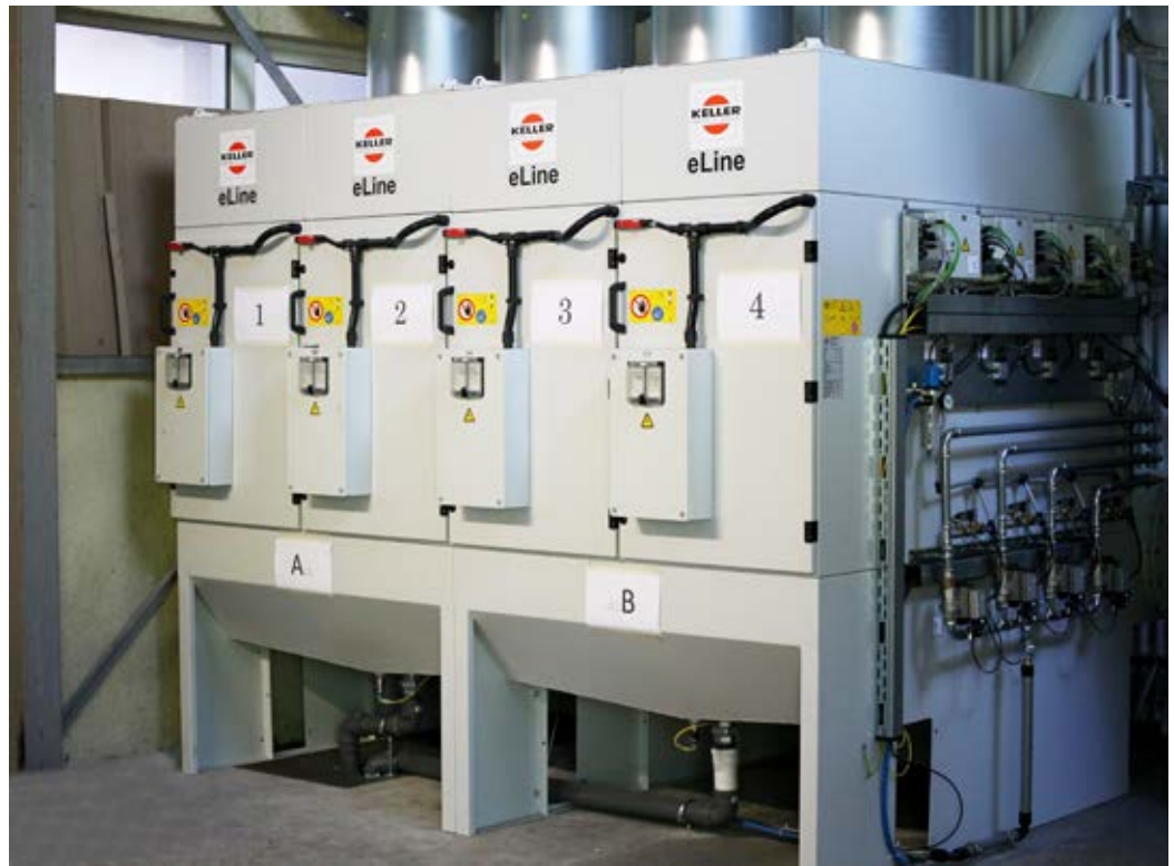
Die vier eLine-Module reinigen die Luft so gut, dass sie in die Halle zurückgeführt werden kann. „Das wird sich bei den Heizkosten im nächsten Winter bemerkbar machen“, sagt Dr. Michael Haas.
