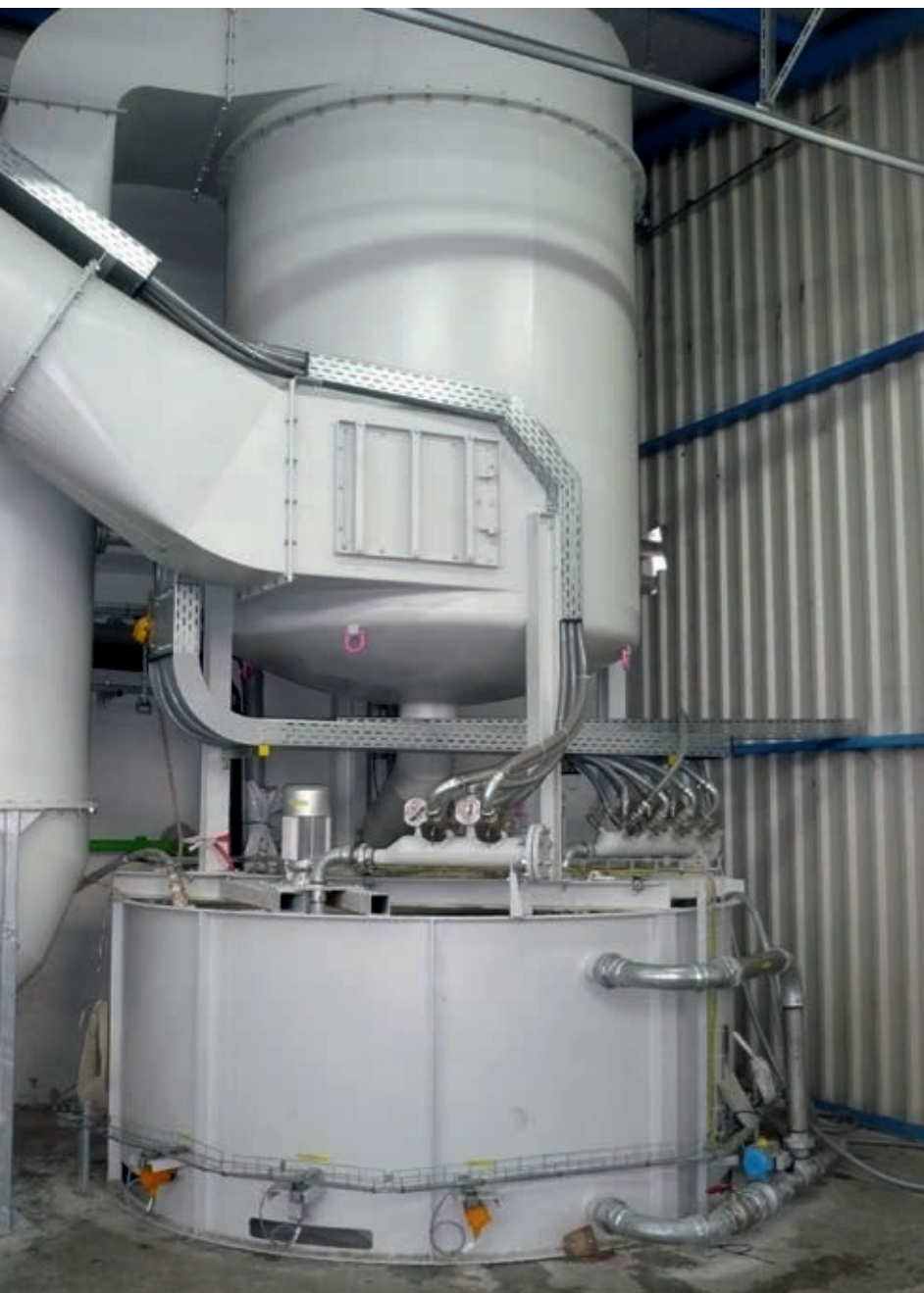
Die Venturi-Nassabscheideanlage regelt automatisch die Luftmenge der neun angeschlossenen Extruder entsprechend dem tatsächlichen Absaugbedarf nach. Das spart bis zu 30 Prozent Energie ein
